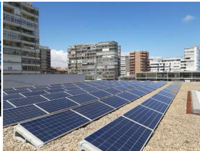
Painéis Fotovoltaicos no Fórum Romeu Correia (Junho 2022)
